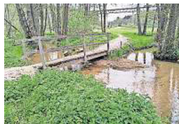
Dieser Steg soll ersetzt werden.
